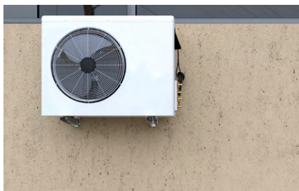
Condizionatori a parete.
